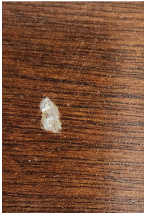
El acabado se está desprendiendo y astillando.
